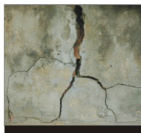
Crack on the wall Vết nứt trên tường
