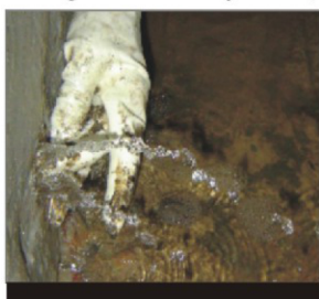
Strong leakage at retaining wall & const. joint Thấm nặng ngay chân tường chắn đất tầng hầm
